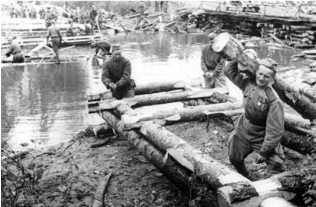
Строительство переправы через реку перед наступлением на Полоцк. 1-й Прибалтийский фронт, июнь 1944 г.
